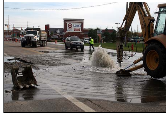
شکل (۱): نشت از خط انتقال [۴]
